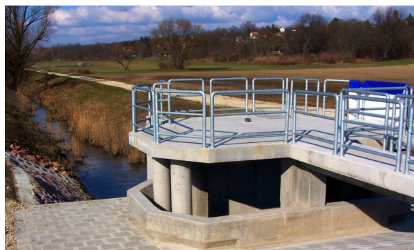
Váli-záportároló vízszintszabályozó műtárgy
