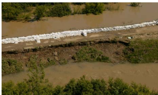
12-16. kép. A töltésen átömlő víz elmosta a mentett oldali részsűt Ócsanál
