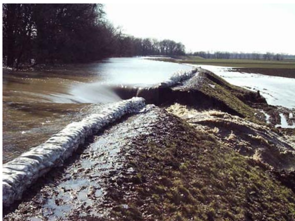
12–13. kép. Gátszakadás a Felső-Tiszán, Tarpánál (2001)
